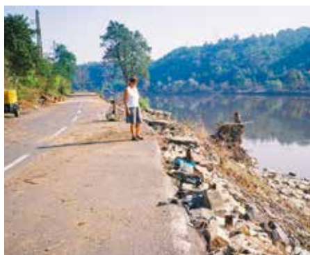
Sílnice na Prahu po ustoupení vody – září 2002
