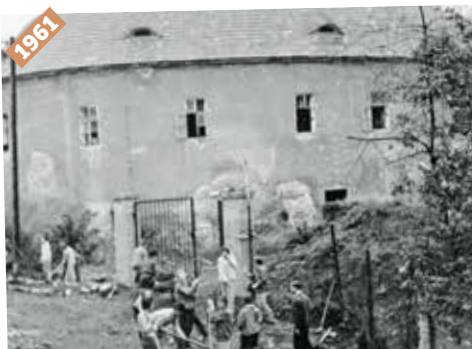
Brigádníci z řad roztocké veřejnosti při stavebních pracích v areálu zámku – oprava chodníků k zámku, 1961
